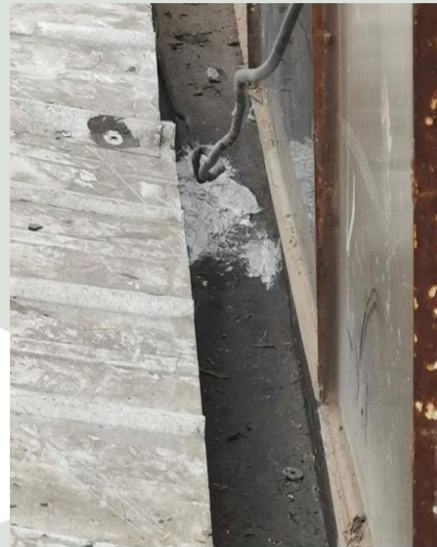
Limpieza de canaletas de aguas lluvias de techumbres ubicados en el primer nivel.
