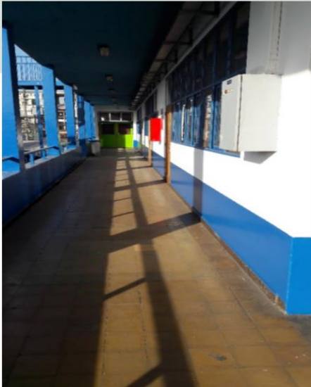
Pintura de muros de pasillos, escaleras y baños con rayados o grafitis.
