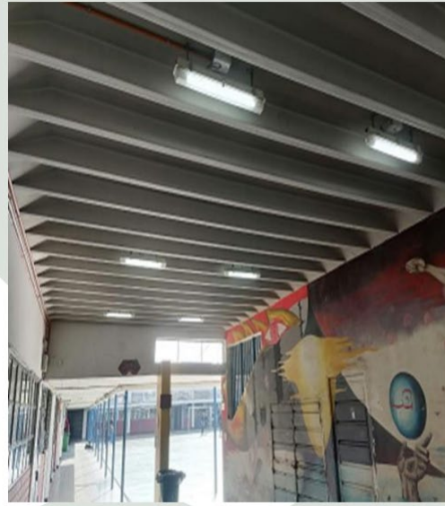
Mantenimiento y cambio de tubos led de equipos ubicados en pasillo que comunica ambos patios.
