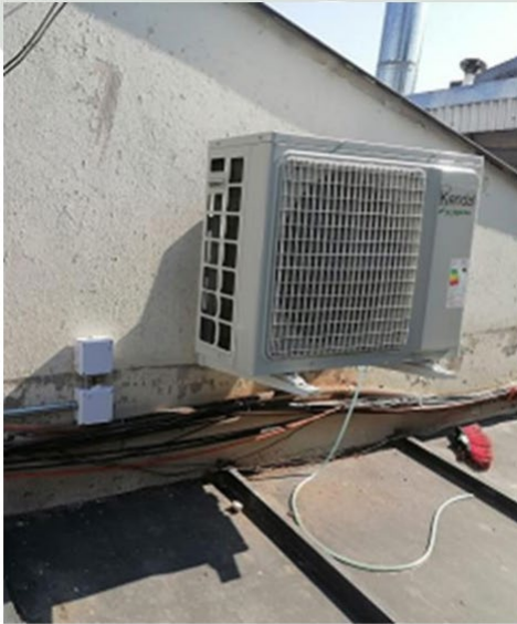
Instalación eléctrica de equipo de AAC ubicado en casino de personal
