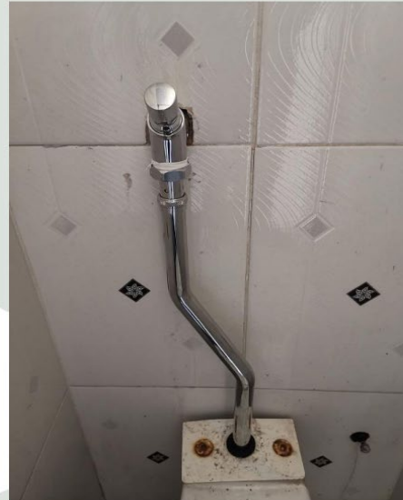
Reemplazo de 3 fluxómetros en mal estado, ubicados en baños de estudiantes
